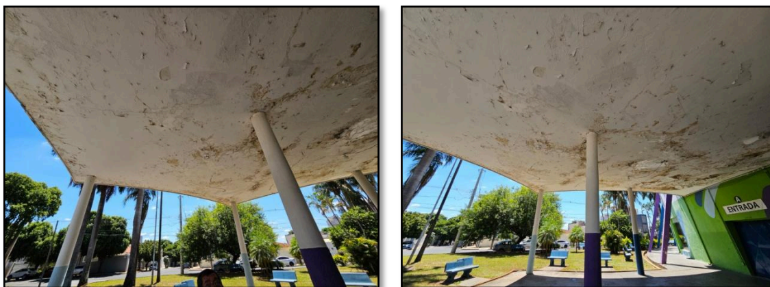
Figura 3 – Laje vista inferior, bolor, umidade e descascamento.
