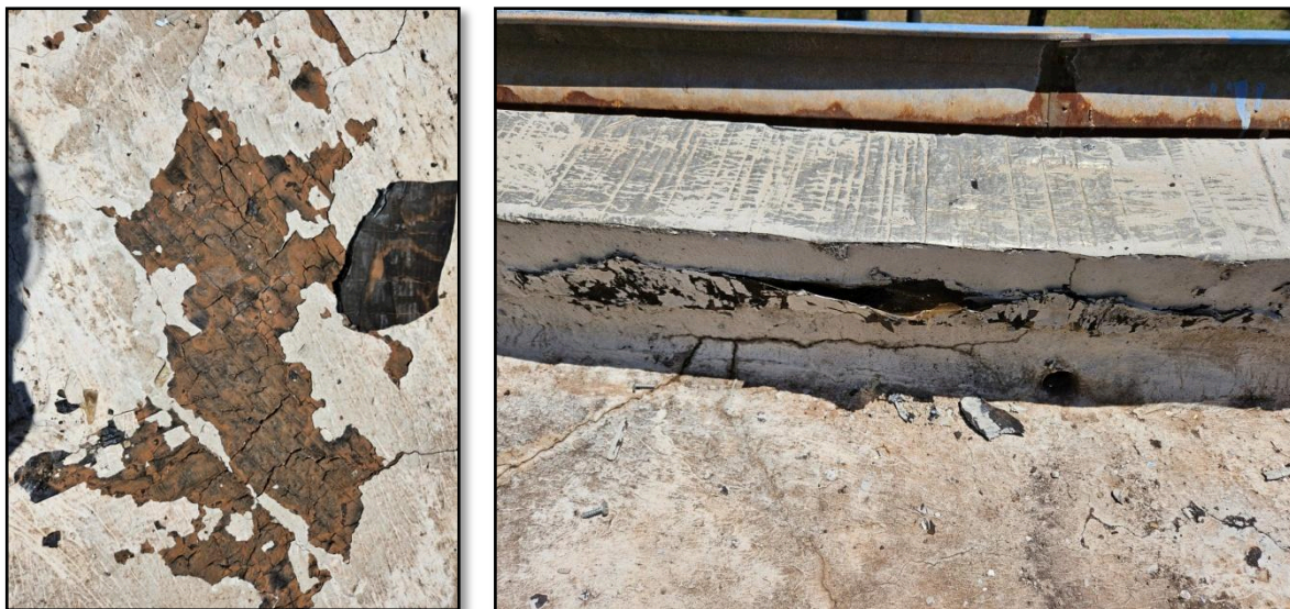
Figura 1 – Impermeabilizações existentes com rachaduras / rodapés deslocando.
