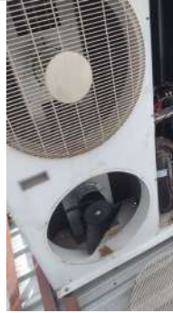
outra hélice do motor do ventilador da condensadora, corredor da copa ( recepção atendimento ) , quebrado.
