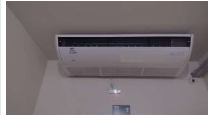
evaporadora corredor copa ( recepção atendimento, consultórios).
