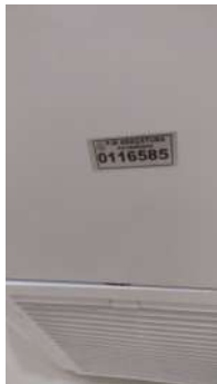
patrimônio, evaporadora corredor copa ( recepção atendimento, consultórios).
